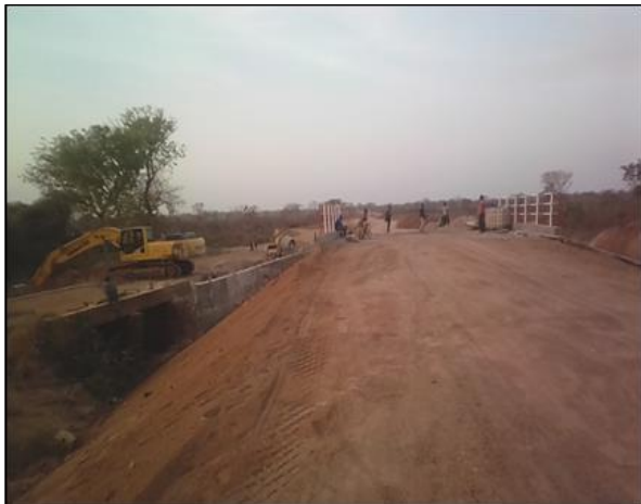
LOT n°4 : Région de la Kara _ Dalot en remplacement du pont vétuste (travaux en finition)
